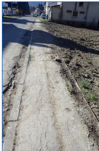
Gehwegschäden (Göttinger Straße)
