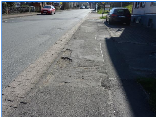
Gehwegschäden (Obere Hilsstraße)
