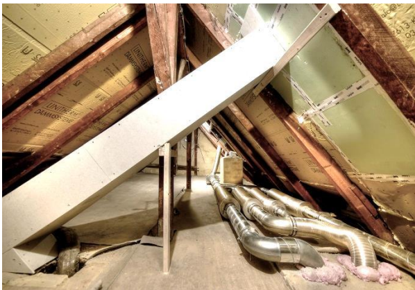
Abbildung 115: Dachdämmung und Rohre der Lüftungsanlage Quelle: (dena)
