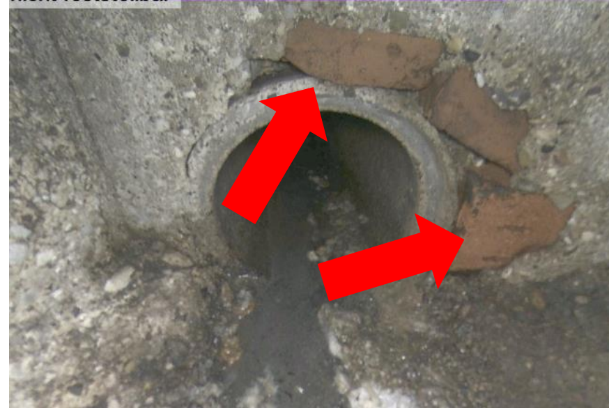
Pos: 12 - 2; Oberflächenschaden, Abplatzung, Ursache nicht feststellbar
