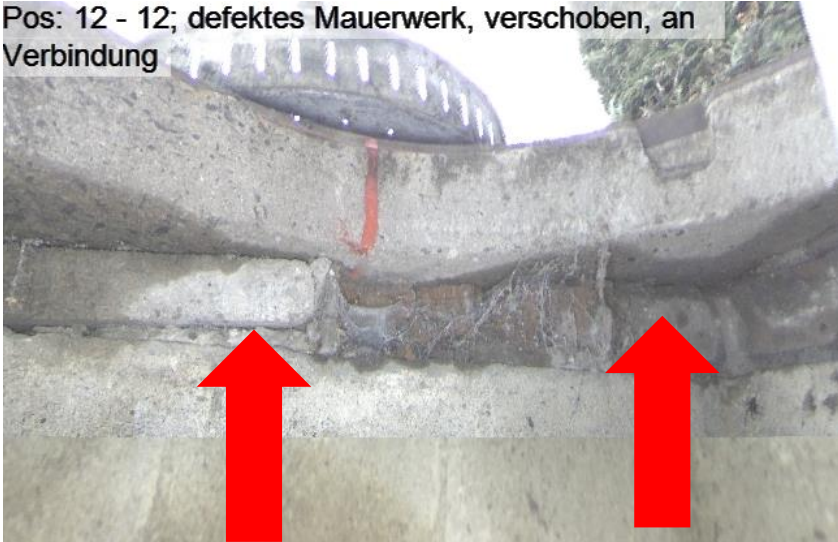
Pos: 11 - 4; defektes Mauerwerk, verschoben, an Verbindung
