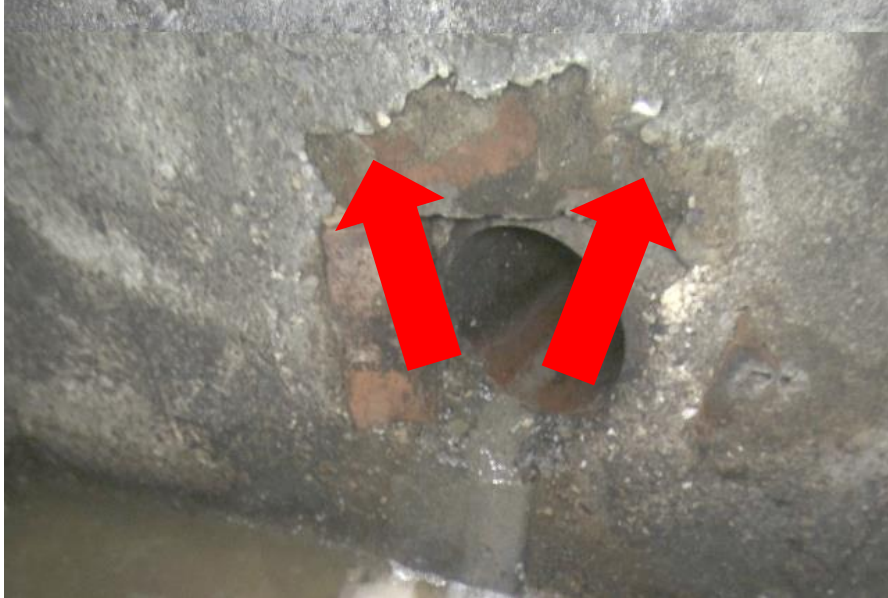
Pos: 2 - 4; Oberflächenschaden, Abplatzung, Ursache nicht feststellbar
